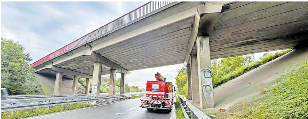
Bei der Brückenprüfung Anfang September wurde festgestellt, dass die Schäden am Bauwerk fortgeschritten sind.
