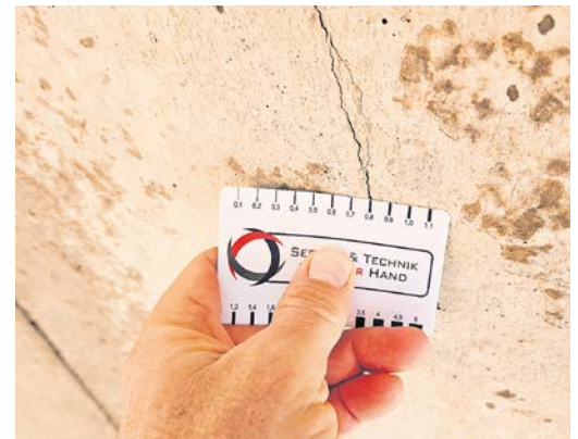
Die vorhandenen Risse haben sich deutlich verändert.
