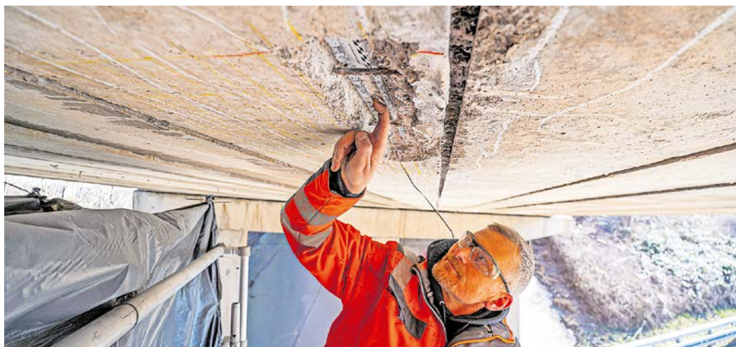
Einzelne Spanndrähte wurden freigelegt und entnommen, um sie im Labor zu untersuchen.
