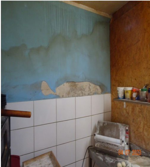
Backstube mit Wandschäden und verschimmelte Lebensmittelreste
