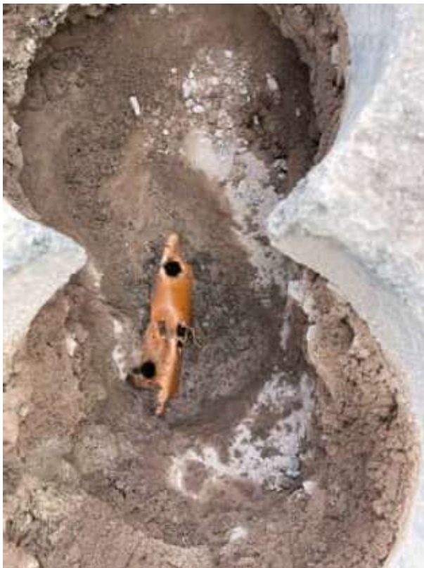
Abb. 5: Bei Stemmarbeiten im Beton beschädigte, nicht zuordenbare Rohrleitung
