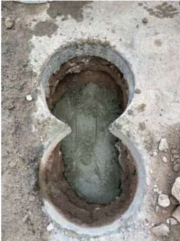
Abb. 7: Einbetten der Rohrleitung in Beton gem. Ausgangszustand
