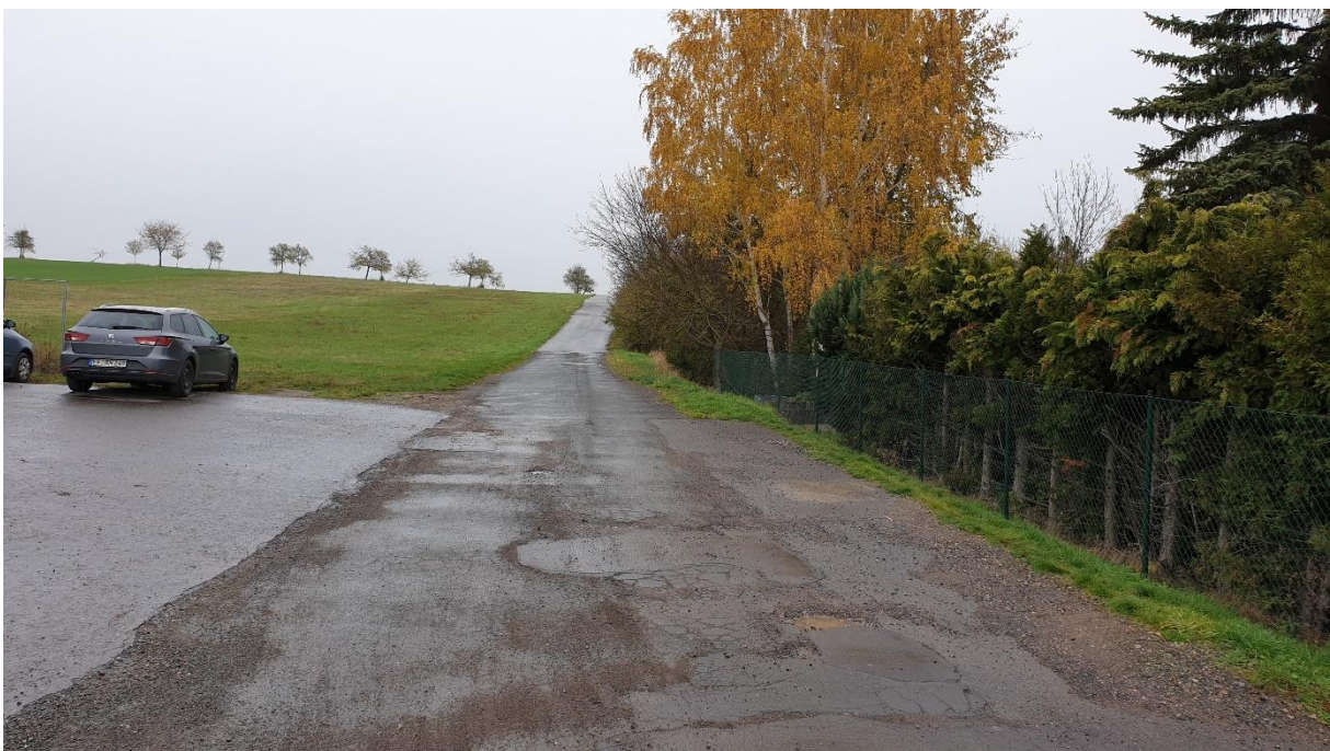
Abbildung 11 Zufahrt, Straße Am Zwetschenberg Foto: G. Weber 08.11.2019
