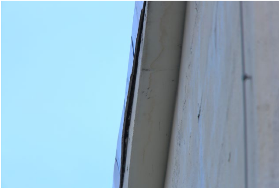
Abb. 21: Gebäude 6 c. Spalten unter dem Dachabschlussblech werden als Fledermausquartier genutzt.
