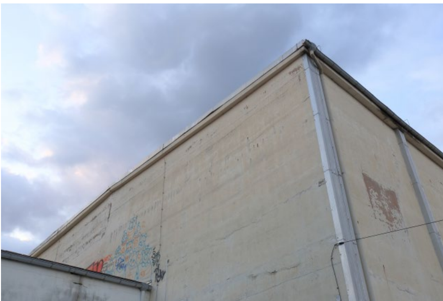
Abb. 20: Gebäude 6 c. Nordfassade Fledermausquartiere unter Dachabschlussblech
