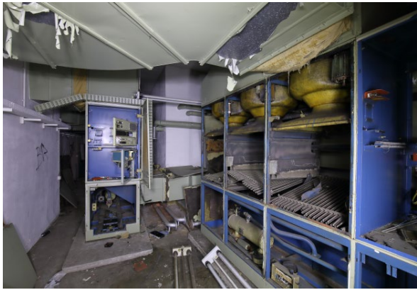
Abb. 10: Abluftanlagen im Obergeschoss
