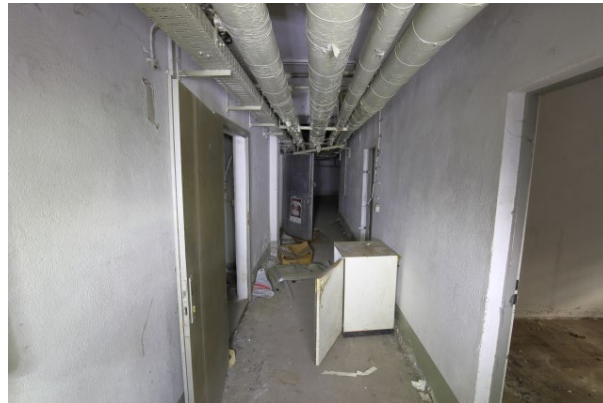
Abb. 6: Keller, Flure mit Versorgungstechnik
