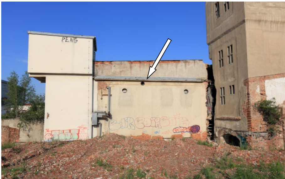
Abb. 33: Nistplatz von F. tinnunculus in einer Ventilatoröffnung der Hauswand
